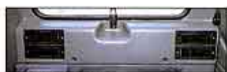
●エアコン吹出口
