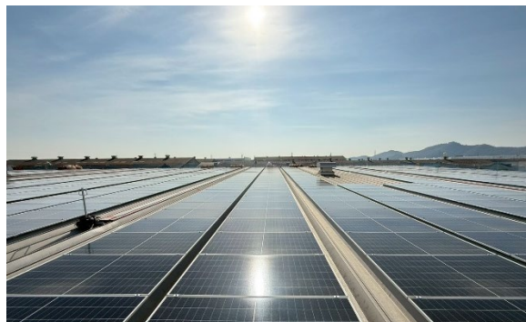
屋根上に設置した太陽光パネル
